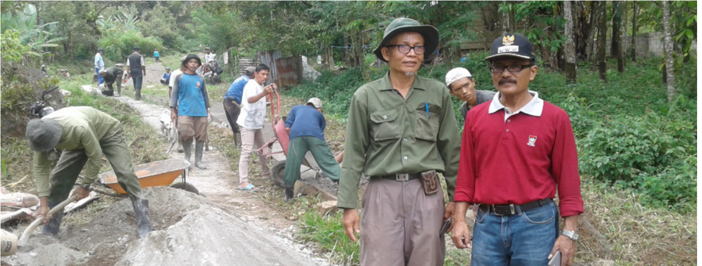
Gotong royong, kearifan lokal HKm Sikayan Balumuik yang menjadi andalan, membangun jalan menuju areal kerja
